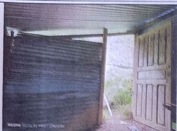
Foto 1: MODULO DE AULAS - mejoramiento de puerta y piso
